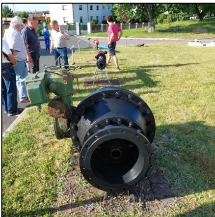
Zeitzeugen der Technik im Außenbereich des Wasserwerkes
