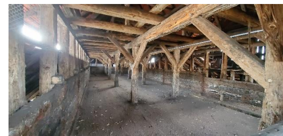
Im Solereservoir (Konrad Grossehelweg, 16.02.2023)
