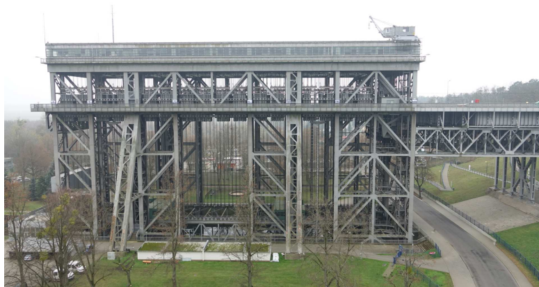
Bild 6: Das alte Hebewerk Niederfinow (erbaut 1926/27-1934); Ansicht von Norden; Auf der Südseite befindet sich der Besucherparkplatz mit dem Informationszentrum.
