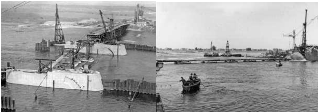
Die Wehrbaustelle der Staustufe Geesthacht ist hier am 23.9.1959 aufgenommen worden (HB00126). Mit dem Bau der Staustufe hatte man im Dezember 1956 begonnen.
