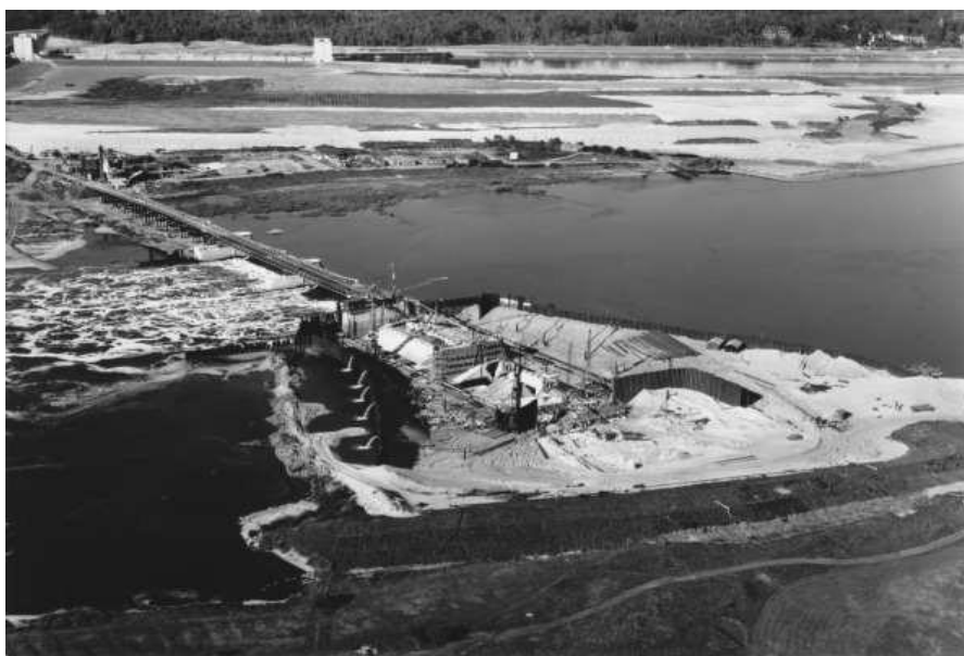
Das Foto zeigt die umspundete und trockengelegte (dritte) Baugrube auf der südlichen Elbe-Uferseite für den Bau der Wehrfelder 3 und 4 des Sektorwehres; Die komplette Staustufe mit der ersten Schleuse und dem
