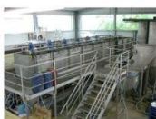
Abwasserreinigung und Klärschlammbehandlung
