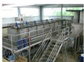
Abwasserreinigung und Klärschlammbehandlung
